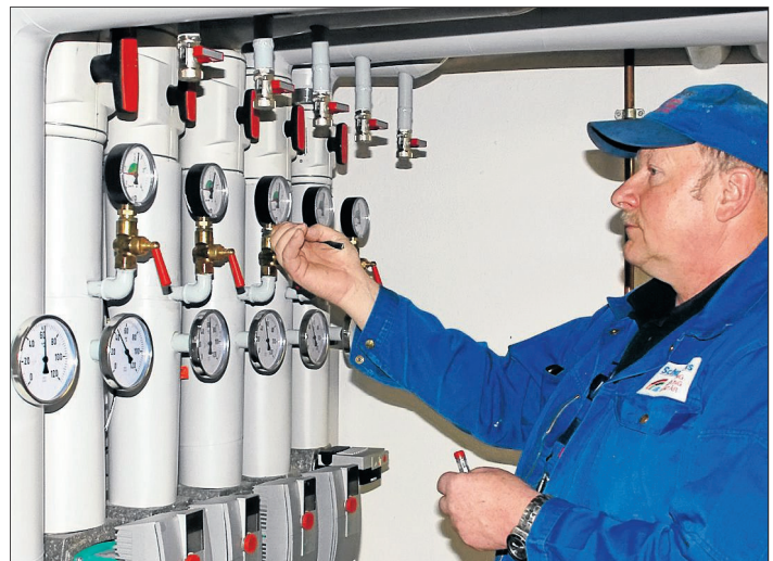
Heizungs-, Lüftungs- und Sanitäreinrichtungen insbesondere auch für große Gebäudekomplexe, wie etwa Krankenhäuser, zu konzipieren, zu installieren und zu warten, ist die große Stärke der Firma Schultheis.
